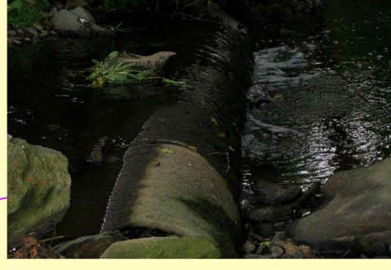
Absturz bei Brücke
