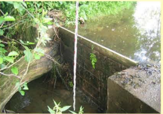
Tonndorfbach bei München, für die Fischfauna nicht überwindbare Sohlstufe
